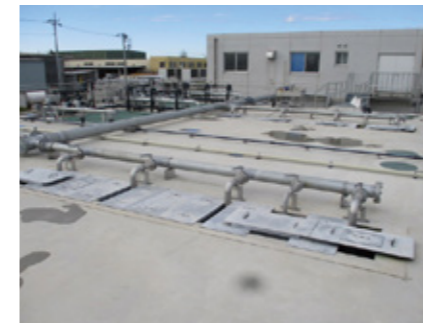
関東工場で増強した排水設備
